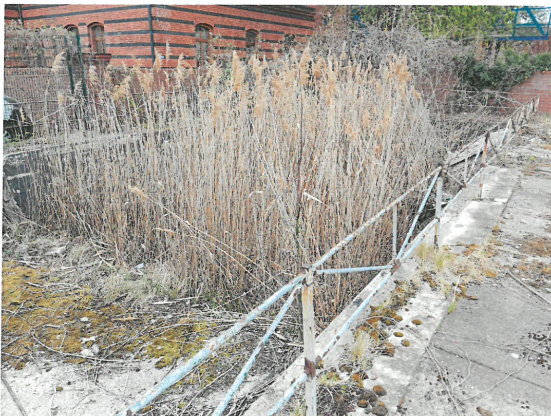
Fot. 2 Porastające krzewy, bariierka ochronna, ścianka i basen z betonową nawierzchnią
