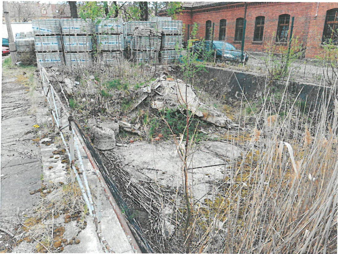
Fot. 5 Basen, porastające krzewy, barierka ochronna, ścianka basenu z betonową nawierzchnią, gruz, korzenie i materiał ziemny zalegający w nieckach basenu
